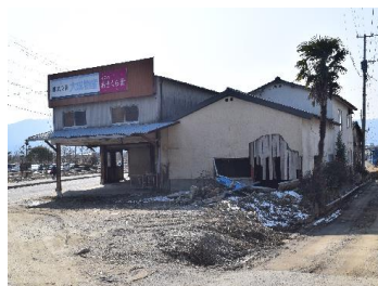
豪雨被害により営業を断念した商店（福岡県朝倉市）
